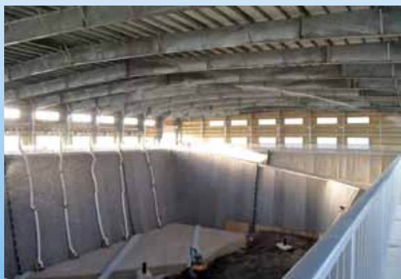
A棟内散水状況
