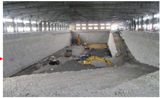
B棟建屋内
